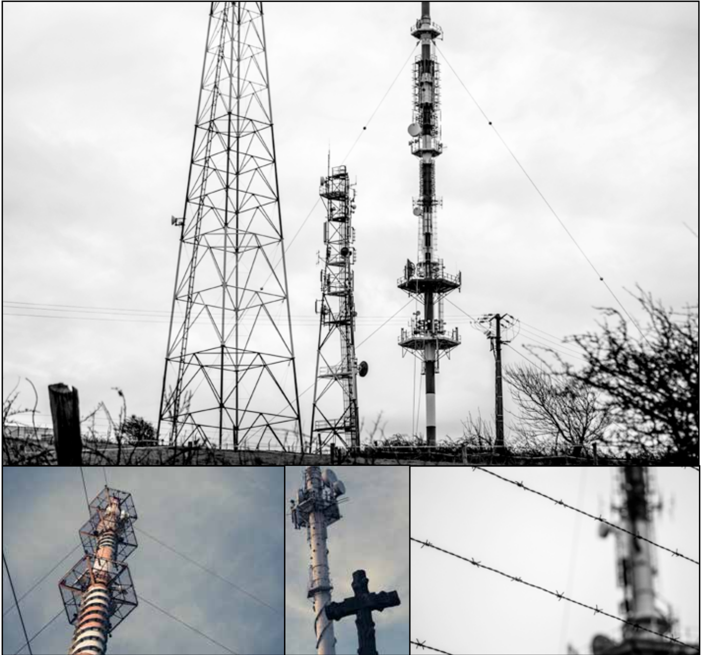
Pylone tubulaire autostable, 109m, Mont-Lambert, 62280 Saint-Martin-Boulogne, France Pylone haubané, 200.4m, Mont des Cats, chemin du Moulin à huile, 59270 Berthen, France photos by JPR 2017
